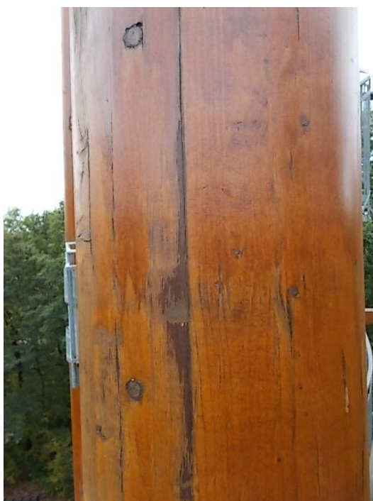
Obr. 16 - Sloup č. 3, díl D, foto zachycuje současný stav povrchu sloupu - ztrátu přilnavosti nátěru a počátek delaminace (vznik trhlin podél lepených spár). Snímek zhotovila zkušebna 07.10.2021
