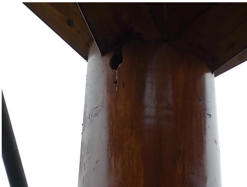
Obr. 4 - Díly E všech tří sloupů, foto ukazuje současný stav - prakticky totožný s obr. 3. Snímek zhotovila zkušebna 07.10.2021
