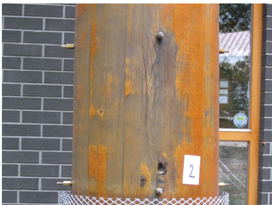
Obr. 14 - Sloup č. 2, díl A, foto zobrazuje současný stav povrchu pod tahokovem - rozrušení nátěru, vznik povrchových trhlin i počátek povrchové delaminace. Snímek byl zhotoven zkušebnou 07.10.2021
