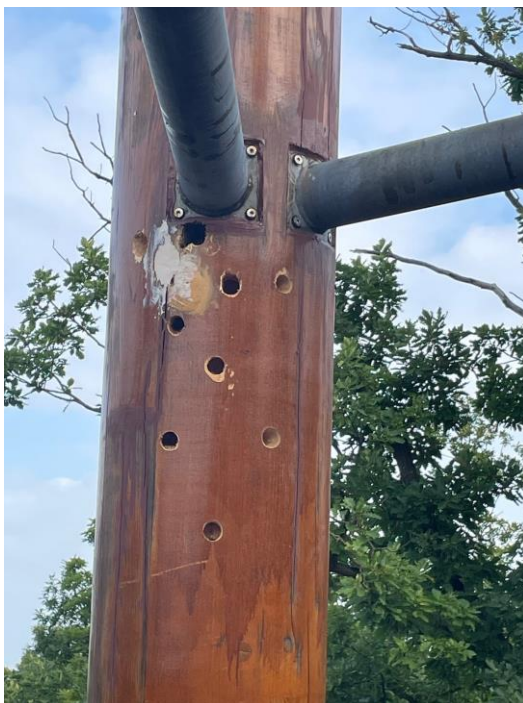
Obr. 6 - Sloup č. 1, díl C, foto zachycuje stav z počátku září t.r. - objevil se nový otvor po napadení strakapoudem a pravděpodobně zákazník v okolí napadení vyvrtal celkem 8 průzkumných otvorů
