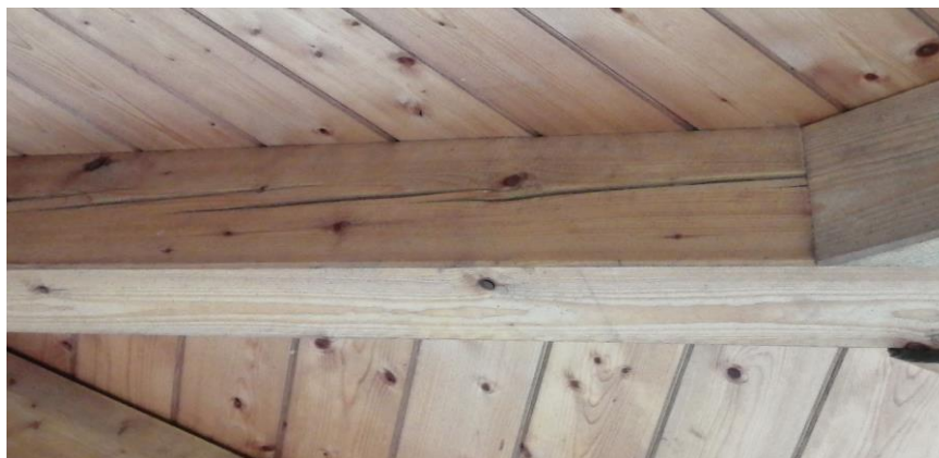
Obr. 17 - Krov vyhlídkové plošiny, Zachycuje velké výsušné trhliny na boku krokve u sloupu č. 3. Snímek zhotovila zkušebna 07.10.2021
