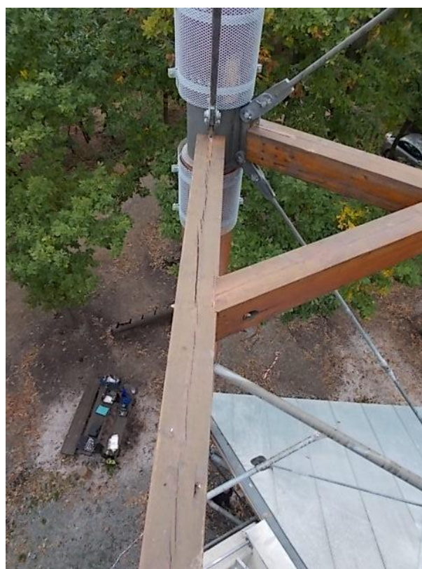
Obr. 18 - Nosné trámy odpočívadla 2, Zachycuje velké výsušné trhliny na horní ploše nosného trámu. Snímek zhotovila zkušebna 07.10.2021
