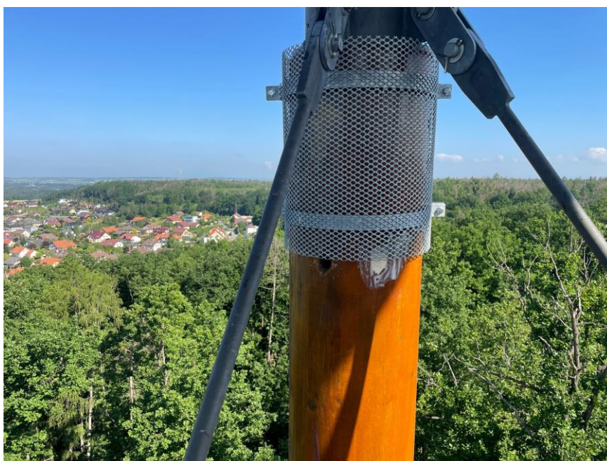
Obr. 8 - Sloup č. 1, díl D, foto zobrazuje stav z června t.r. - vyskytovaly se celkem 2 otvory po napadení strakapoudem (jeden byl zatmelený). Snímek zhotovil zákazník 14.06.2021
