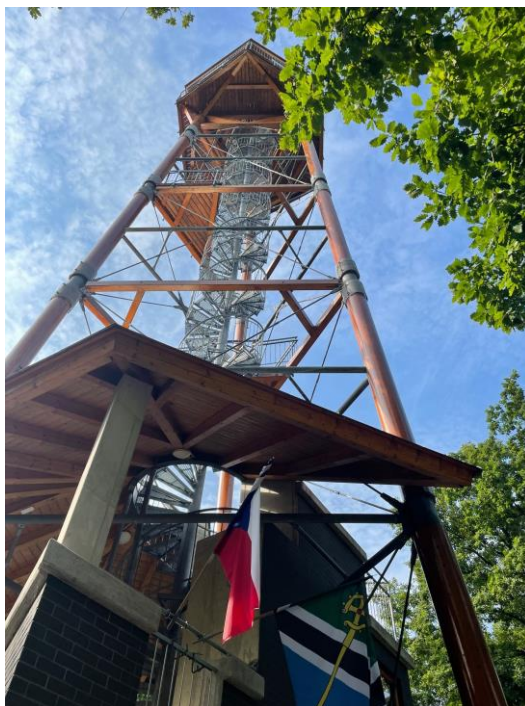
Obr. 1. Pohled na přední stranu rozhledny s vchodem do ní. Nejvíce napadený a rizikový sloup je vpravo od vchodu (dále označený pořadovým číslem 1.), vlevo od vchodu je sloup označený pořadovým číslem 3. Snímek byl zhotovený zákazníkem dne 07.09.2021.
