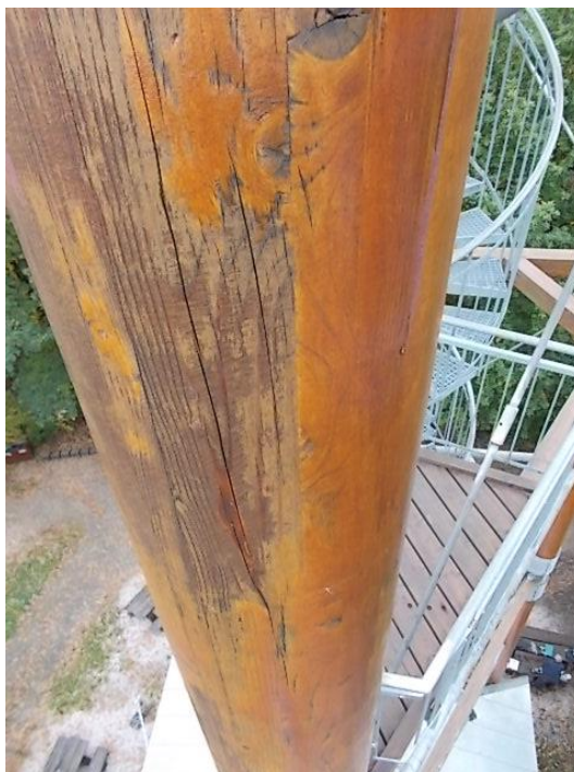
Obr. 12 - Sloup č. 1, díl D, foto zachycuje současný stav povrchu sloupu - zachycena totální destrukce lakového nátěru, výsušné trhliny i počátek povrchové delaminace. Snímek zhotovila zkušebna 07.10.2021
