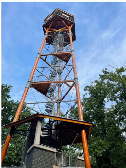
Obr. 2. Pohled na zadní stranu rozhledny. Vlevo na snímku je sloup č. 1 a vpravo pak sloup č. 2. Snímek byl zhotovený zákazníkem dne 07.09.2021
