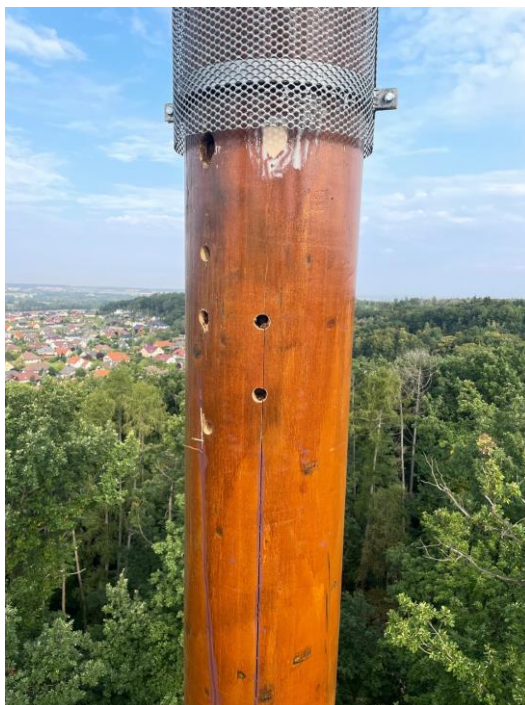
Obr. 9 - Sloup č. 1, díl D, zachycen je stav z počátku září t.r. - pravděpodobně zákazník v okolí napadení vyvrtal dalších 5 průzkumných otvorů (minimálně ve dvou z nich jsou zřetelné hnědé drtiny). Snímek zhotovil zákazník 07.09.2021
