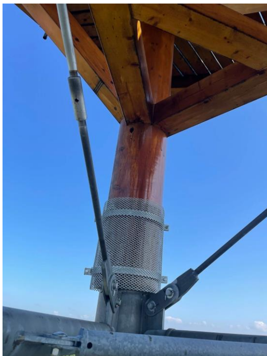
Obr. 3 - Díly E všech tří sloupů, foto zobrazuje stav z června t.r. - otvor po napadení strakapoudem pod vzpěrou podlahy vyhlídkové plošiny. Snímek zhotovil zákazník 14.06.2021
